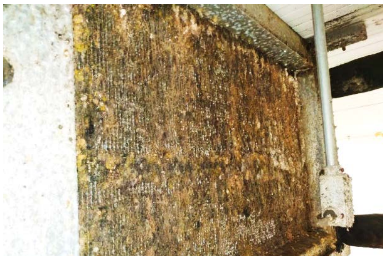
Figura 1 – Núcleo aletado com grossa camada de sujidade
